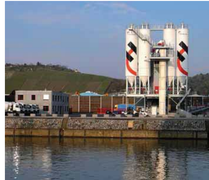
Das Betonwerk kann jährlich bis zu 100.000 m³ Beton produzieren
